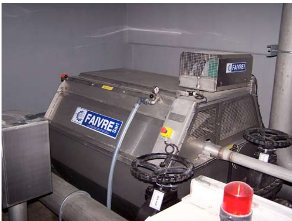
Filtre 9-120 sur cuve
