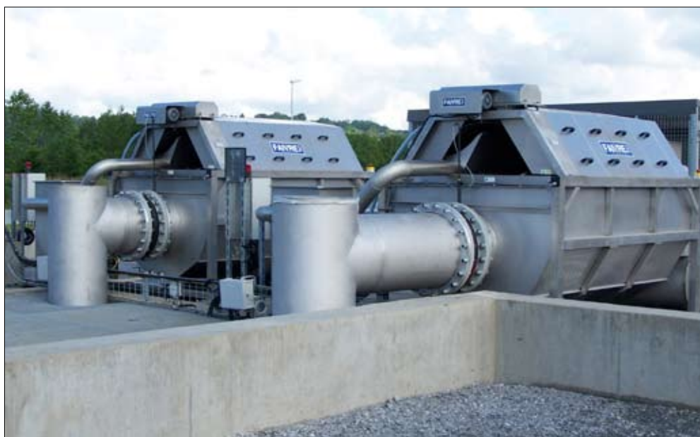
2 filtres 12-160 sur cuve INOX en filtration d'eau chargée.
